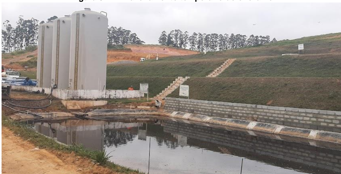
Figura 37: Armazenamento temporário do chorume.
