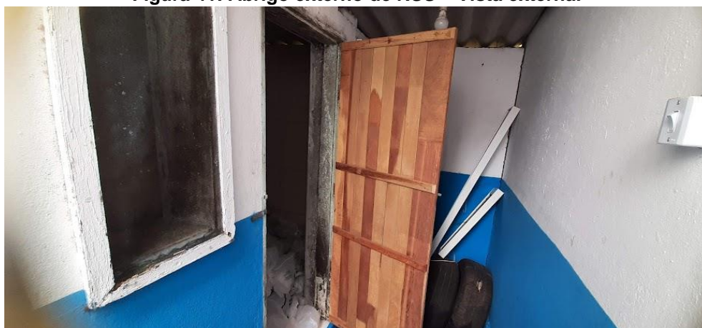
Figura 41: Abrigo externo de RSS – Vista externa.
