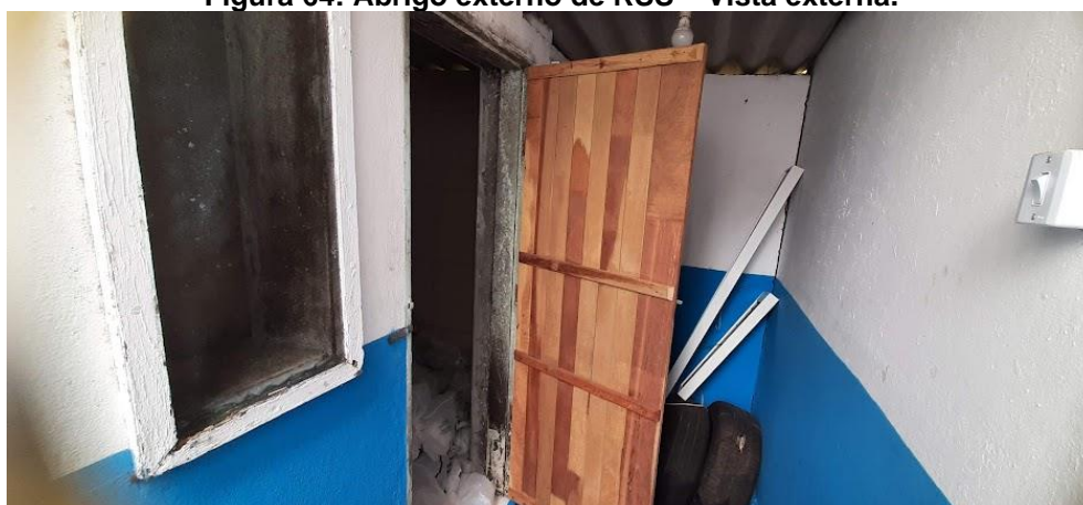
Figura 64: Abrigo externo de RSS – Vista externa.
