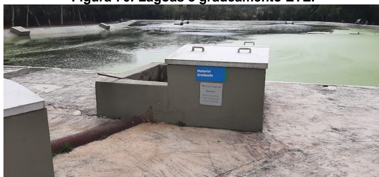
Figura 76: Lagoas e gradeamento ETE.
