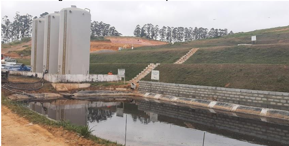
Figura 60: Armazenamento temporário do chorume.
